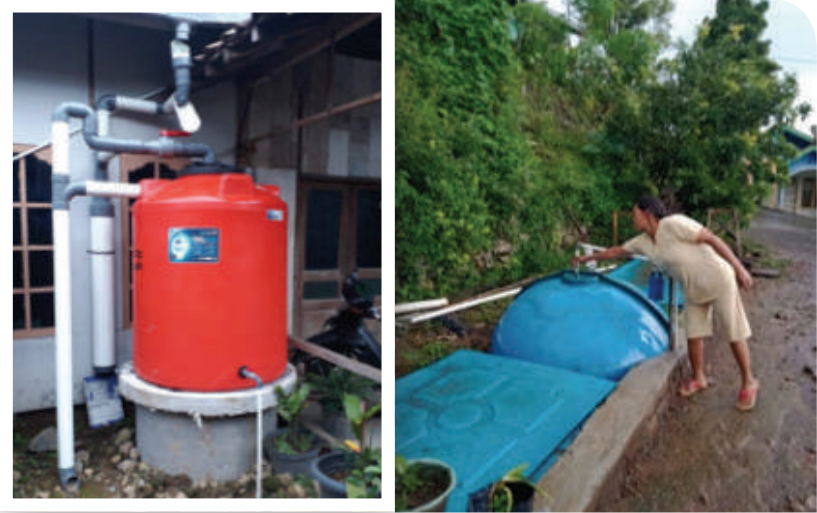
Instalasi pemanenan air hujan (IPAH) dan IPAL Biogas di Dusun Banyudono, Desa Gedong.
